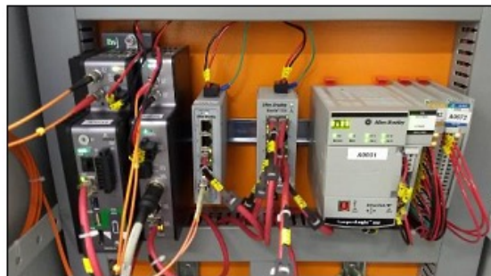
CLP e Registrador (Painel Principal)
