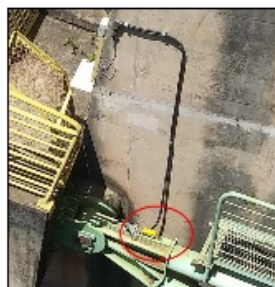
Inclinômetro Angular Vertedouro
